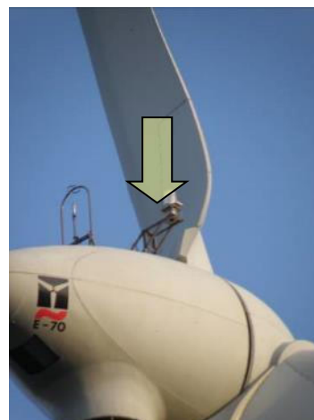
Figure 74 : Signalisation sur une éolienne ENERCON (Source : IE)
